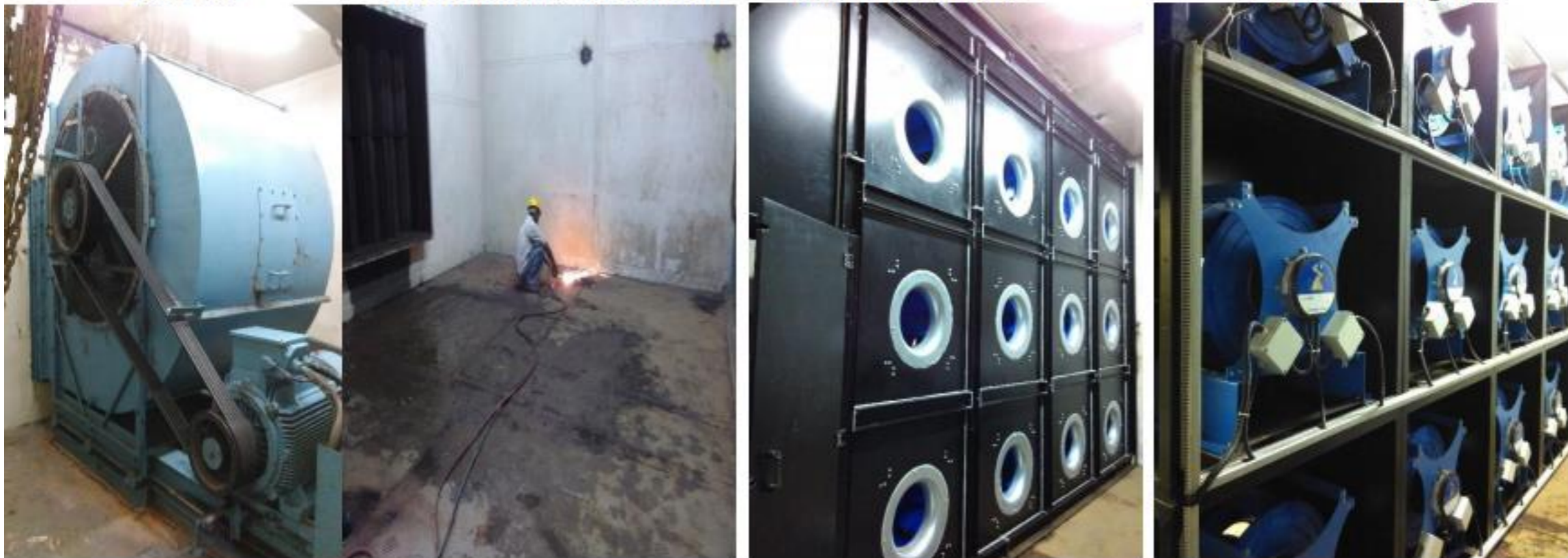
New EC fan discharge Side
